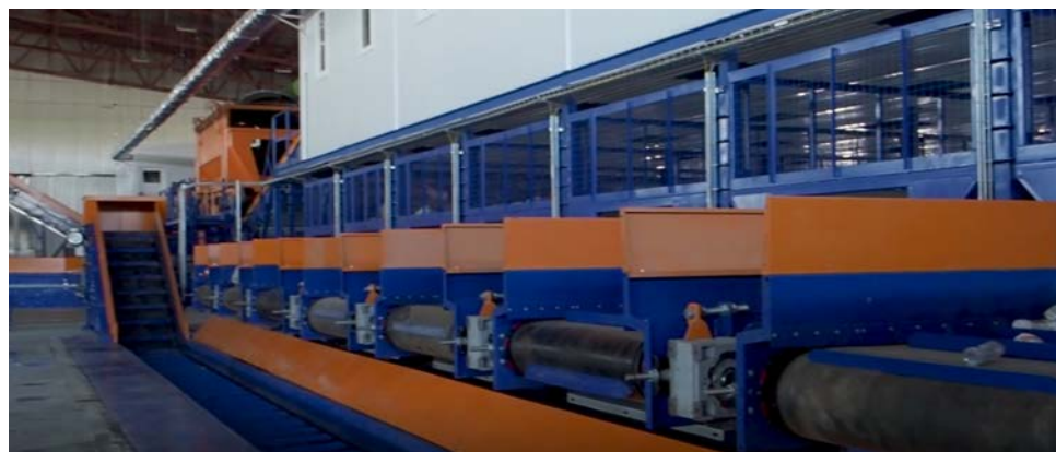
Комплекс автоматической сортировки ТКО
